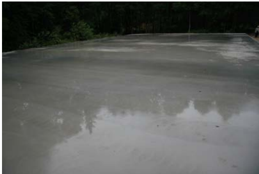
具抗滲性，水份停留於混凝土地坪表面。
