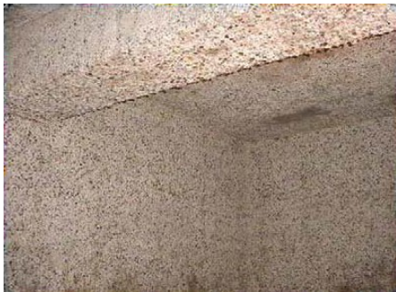
污水槽遭嚴重侵蝕而骨材外露
