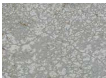
未添加「即固 T-280」的混凝土面呈現乾縮龜裂
