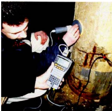
嚴重鏽蝕的橋柱正以 GalvaPulse 儀器進行測量
