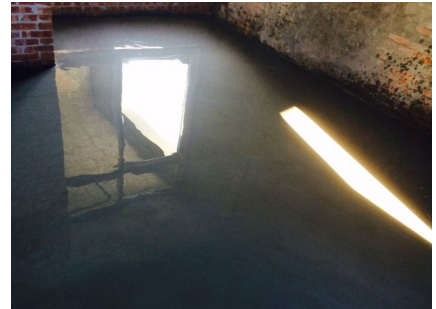
混凝土地坪第2~3天養護後，水份仍停留於表面不被吸收。
